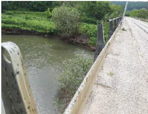
Слика 12.30 – Недостатак сегмента заштитне ограде на мосту
