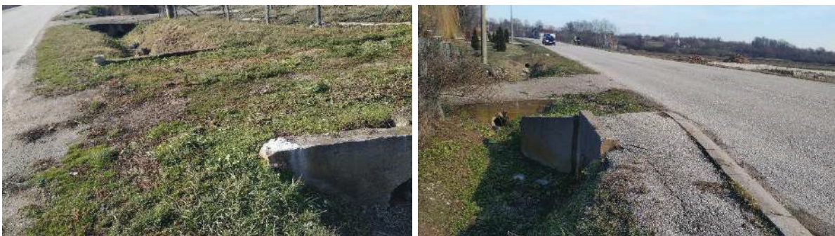
Слика 11.18 – Примери бетонских „ћуприја“
