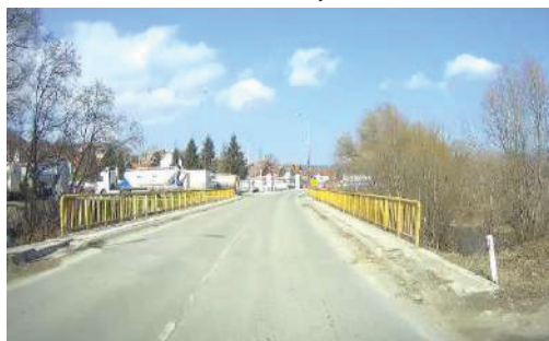
Слика 12.32 – Неадекватна ограда на мосту, недостатак заштитне ограде за возила
